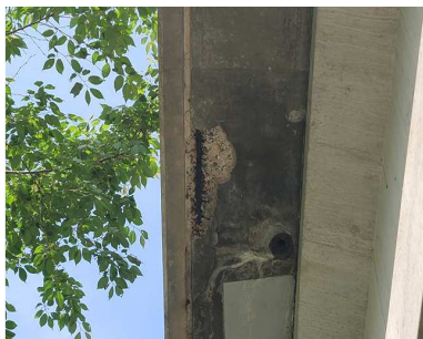
① 바닥판하면 S1 박락 및 철근노출 - 진전 여부확인
